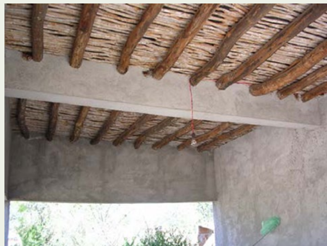
Fig.9.- En el poblado de Masiaca, se aprecia la trabe de concreto dividiendo el espacio interior y permite que los morrillos no mayores de 3.00 m y diámetro de 15 cm., conserve el carácter regional con la tradición vernácula mayo.
