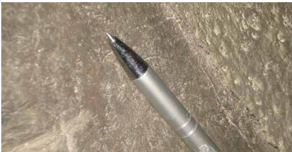
Figura 2. Espesor del concreto lanzado.
