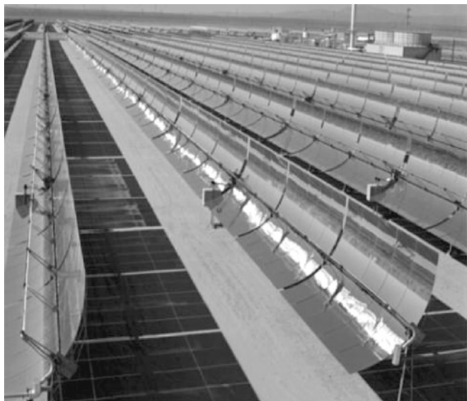
Figura 4. Vista del arreglo de canales parabólicos en la SEGS en California.
